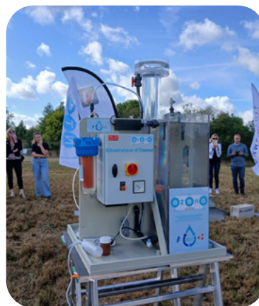
Système de traitement des eaux usées à l'ozone - STEP de La Bouëxière et STEP de Saint-Aubin-du-Cormier - Source : LCC
