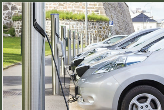
Bornes de rechargement des véhicules électriques
