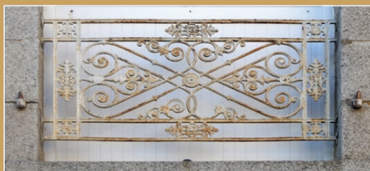
Garde-corps en ferronnerie à conserver et à entretenir
