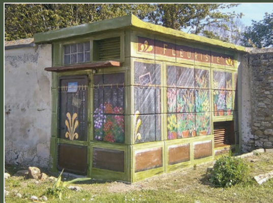
Exemple de poste électrique peint (src. ENEDIS)
