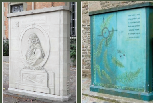
Exemples d'armoires électriques
