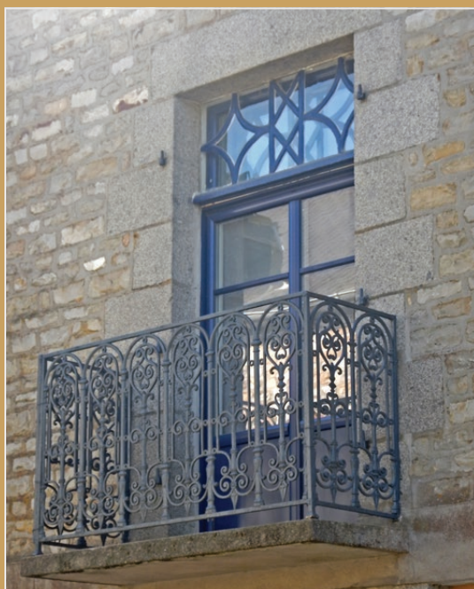
Garde-corps et imposte à conserver et à entretenir
